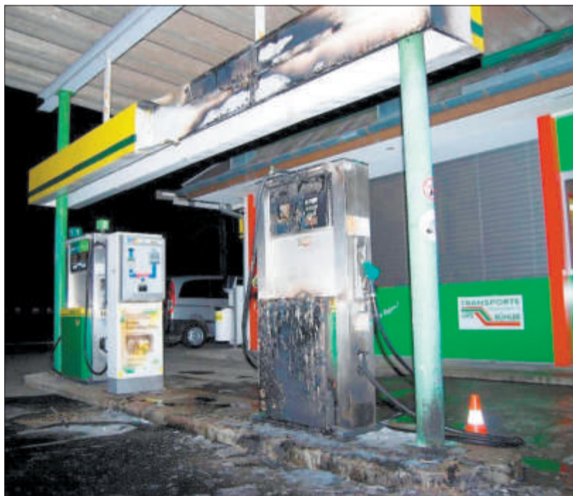
Die Brandspuren an der Tankstelle an der Entlebucherstrasse 79 in Wolhusen. PD
